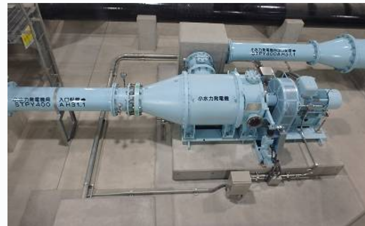
小水力発電設備 (江北給水所)
