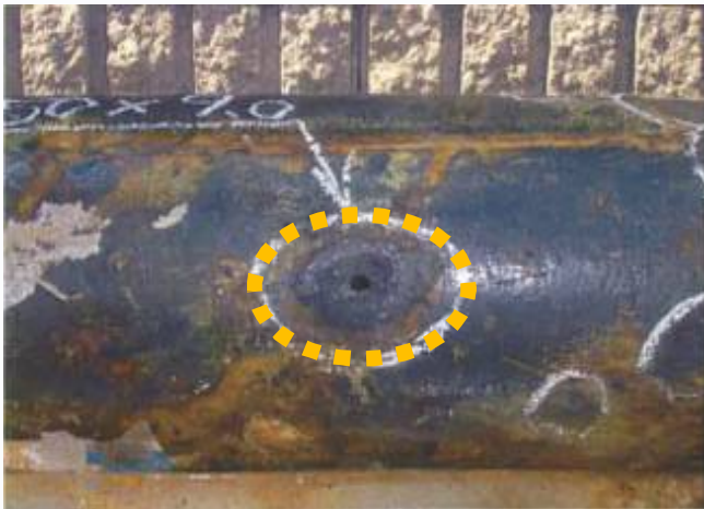
〈孔食の状況写真〉
