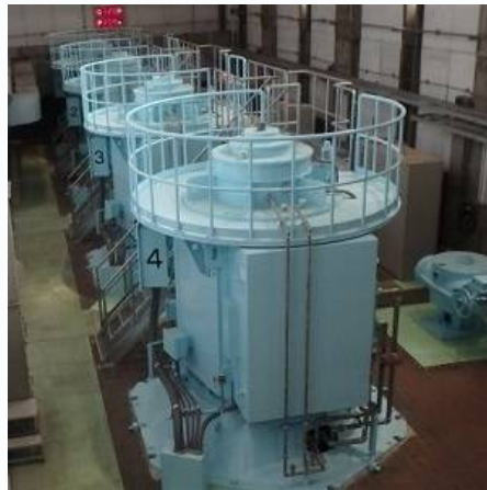
省エネ型ポンプ設備 (上井草給水所)
