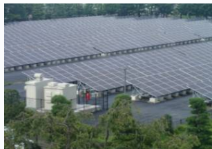
太陽光 発電設備 (東村山浄水場)
