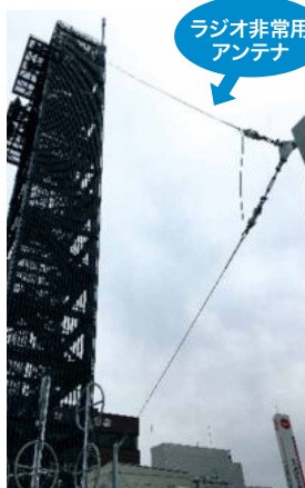
ラジオ非常用アンテナ (熊本放送会館)
