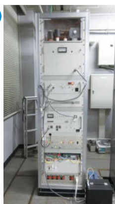
ラジオ非常用送信機 (出力100W) (富士放送会館)
