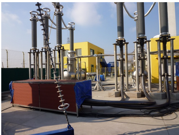
図2 試験回路をCVケーブル側から見た。手前の6本のシリコン碍子がCVケーブルの終端部で奥が超電導ケーブルの終端部。手前の赤いボックスに交流電用のトランスが収納されている。
