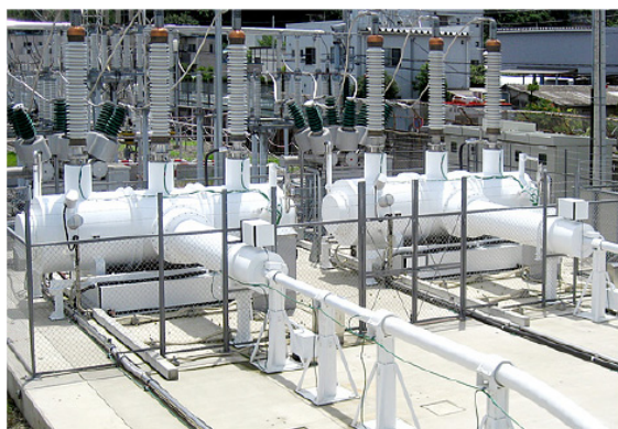
図4 超電導ケーブル端末部付近
