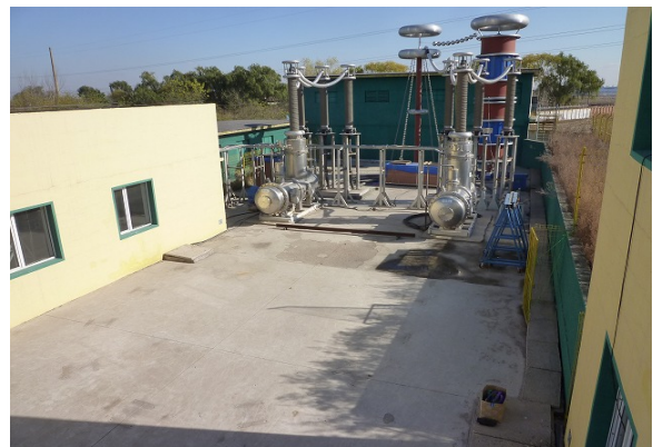
図3 試験後の瀋陽古河の超電導ケーブル試験場。新しいケーブル試験にいつでも対応できる。
