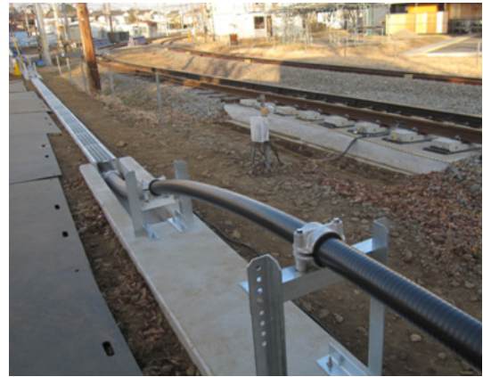
図3 敷設した30 m級鉄道用超伝導ケーブル
