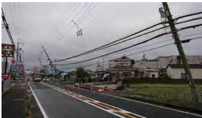
2018年 台風21号による強風被害(電柱が折れる) (提供: 摂南大学 池内 淳子 氏)
