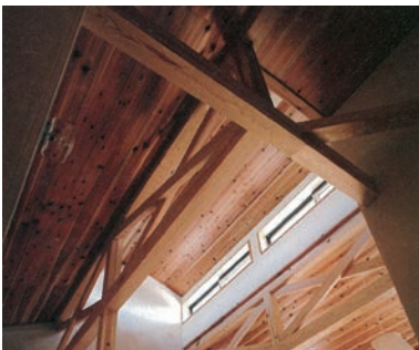
越屋根に設けた開口を開放して、暖められた室内空気を排出する (写真:①)
