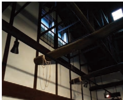
伝統的な町家の土間の採光と換気を確保する高窓と天窓
