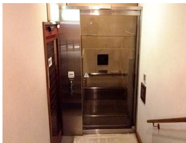
北殿（ほくでん）の段差昇降機
