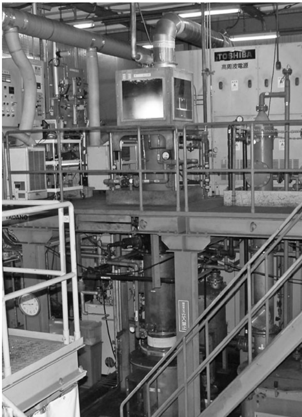
図1 北九州エコタウンのRF熱プラズマによるフロン分解プラント (西日本家電リサイクル株式会社提供)。
