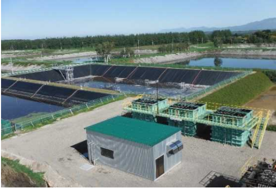
【 中央制御室と4箇所の曝気槽 】
