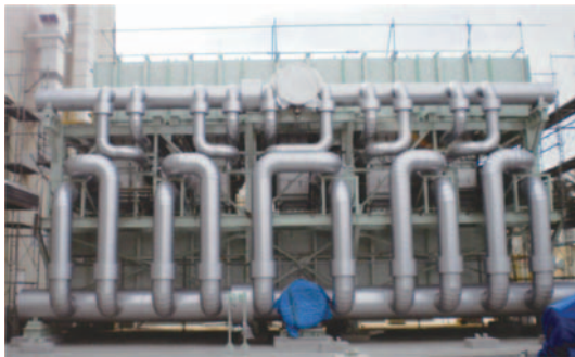
図14 再生熱交換器外観
