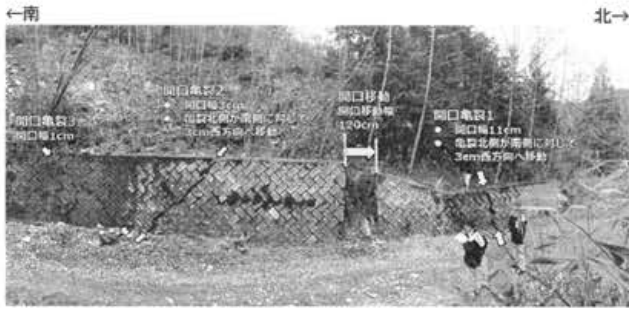
図-6 白髪山地区におけるコンクリート擁壁の変形状況 (2016年3月10日撮影)
