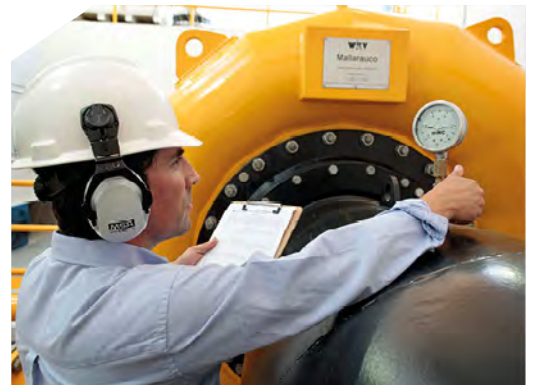
↙ Kleinwasserkraftwerk Mallarauco in der Nähe von Santiago de Chile
