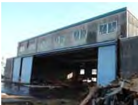
(a) 被災後の格納庫（正面）
