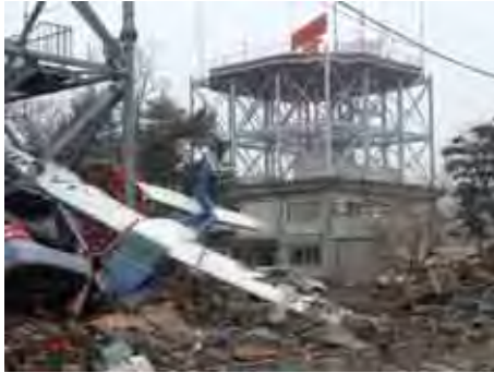
(a) 被災後の岩沼分室庁舎
