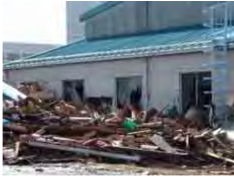
(a) 被災後の格納庫（裏面）
