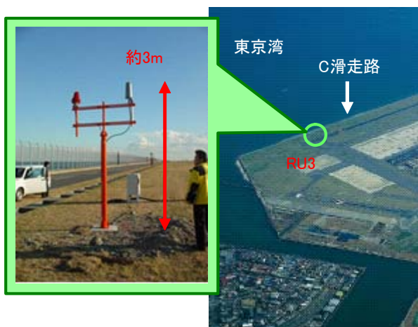
図2 RU3アンテナの設置状況
