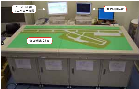
図12 灯火制御&モニタ表示装置、灯火模擬パネル外観
