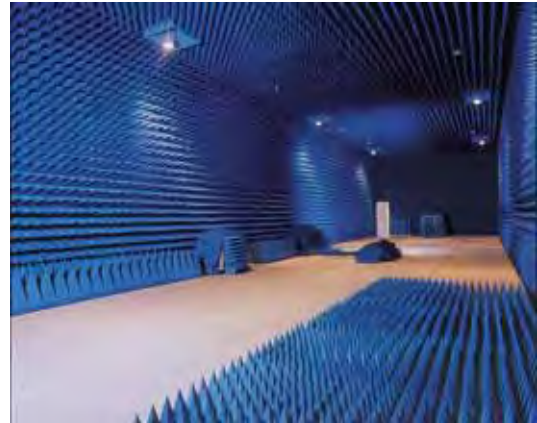
【改修後の電波無響室】
