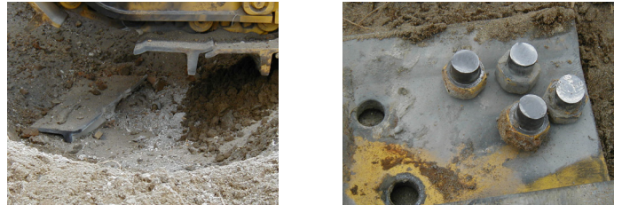
写真 6 シュー脱落・ボルト折損
