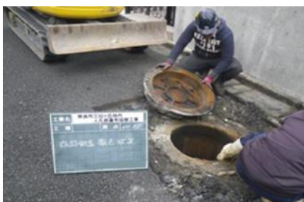
老朽化したマンホール蓋
