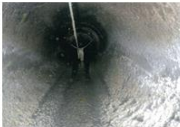
既設管状況 コンクリート劣化
