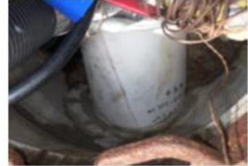
蒸気により圧力をかけて左記の材料を既設管内で膨らませている状況
