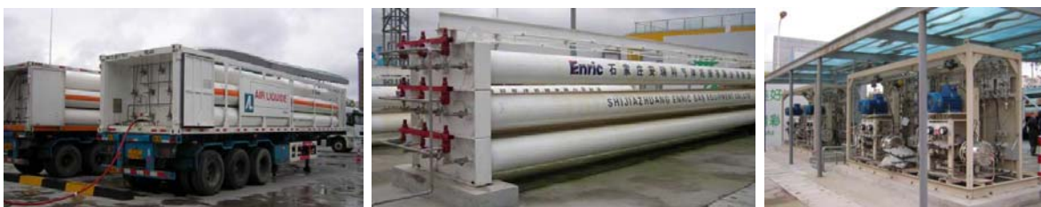
図 5.6-6 水素源（Air Liquide）、圧縮機、蓄圧器
