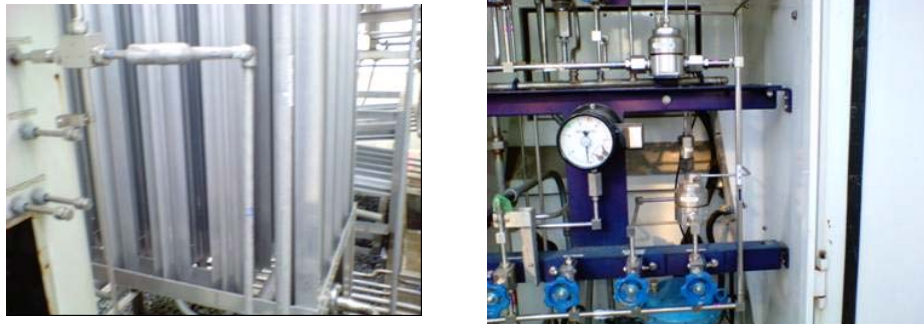
図 1.1.5-7 蒸発器、高圧水素ディスペンサー内部
