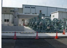
(c) 真空ポンプ
