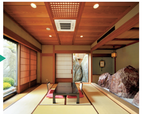
LEDダウンライト600シリーズに更新された東殿客室の照明
