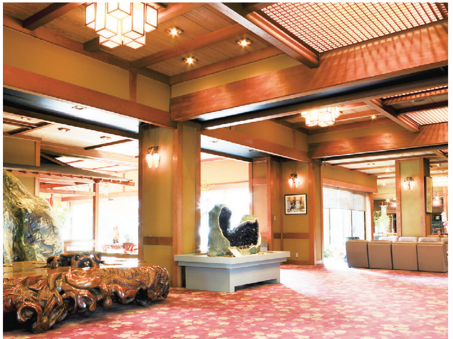
ロビー・ラウンジの照明 ダウンライト及びブラケットは白熱灯からLED電球一般電球形(電球色)に更新し、消費電力を削減
