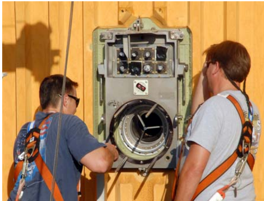
水素ガスベントラインが取り外された様子 (銀色の部分がGUCP、薄緑色の部分がETCA)
