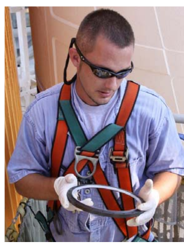
取り外されたGUCPの内部シールの状態を確認している
