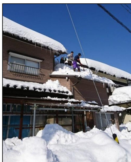
坂井市丸岡町城北 高齢者宅の屋根雪おろし (2/9)
