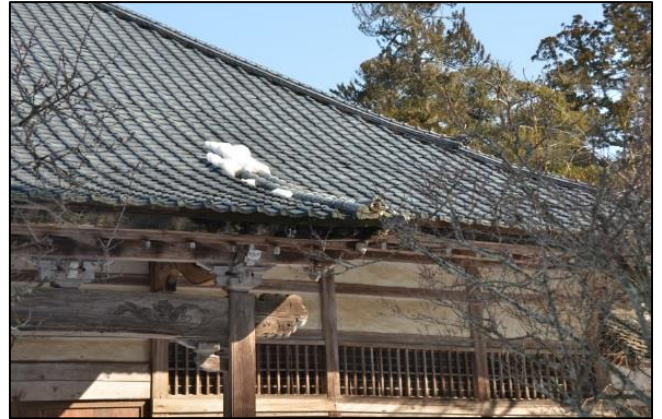
瀧谷寺 本堂 屋根破損状況
