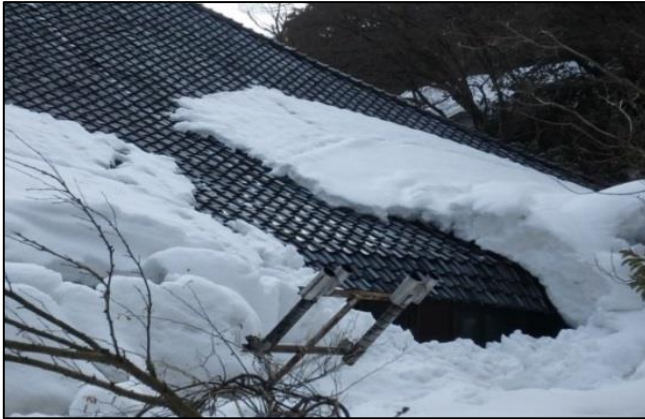
大安寺 庫裏 屋根軒先折損状況
