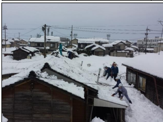
あわら市：市営住宅の屋根雪おろし（2/10）
