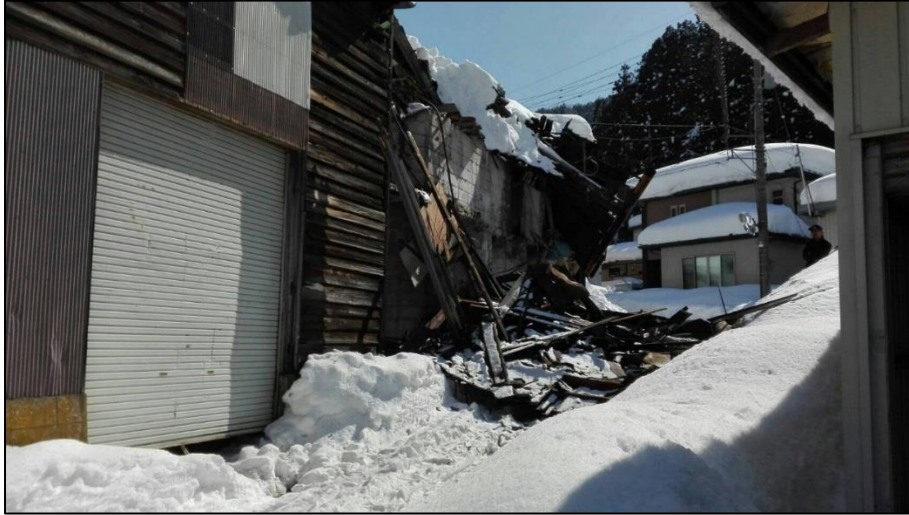
製紙所の工場棟一部倒壊（越前市）
