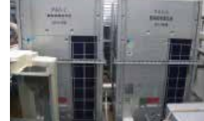
室外機(更新後)
