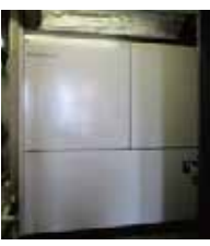
室内機(更新後)
