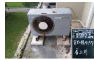
室外機(更新前)
