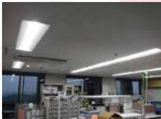
室内機(更新前)
