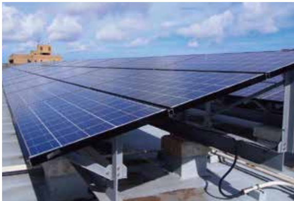
図書館屋上太陽光発電設備（定格容量 80Kw）
