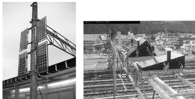
写真-9 両面受光型太陽電池電源による融雪装置
