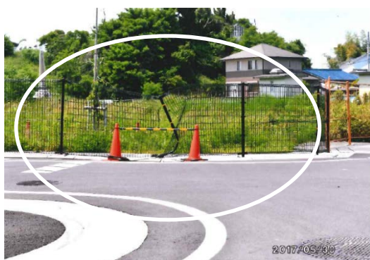
交通事故で壊れたフェンス
