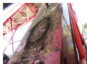
鋼部材の防食機能の劣化状況
