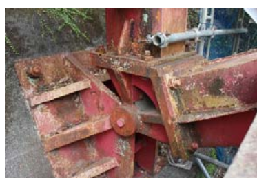
支承との取付ボルトのナットに欠け(減肉)
