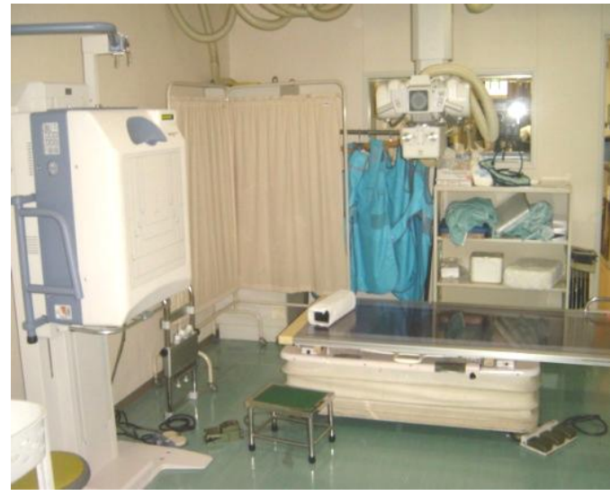
一般撮影検査室
