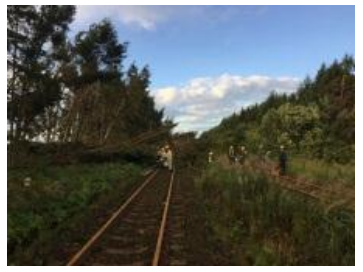
【倒木・電化柱折損・電線切断】 函館線 大沼～長万部 約200本の倒木
