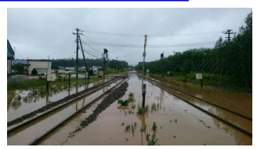
【橋りょう流失】 根室線 十勝清水～羽帯 清水川橋りょう
