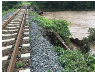
【路盤流出】 根室線 十勝清水～羽帯 平野川橋りょう
