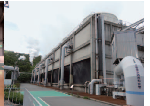
写真4 温水を冷却する「冷却塔」
