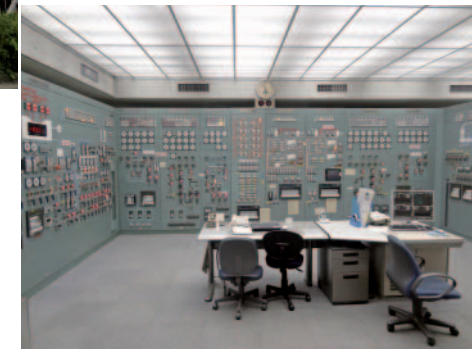
写真5 地熱発電を制御する「中央制御室」
