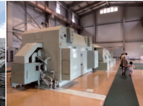
写真3 蒸気ので1分間に3600回転する「タービン・発電機」
