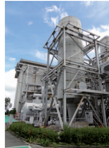
写真2 200度以上の流体が蒸気と熱水に分離される「気水分離器」
