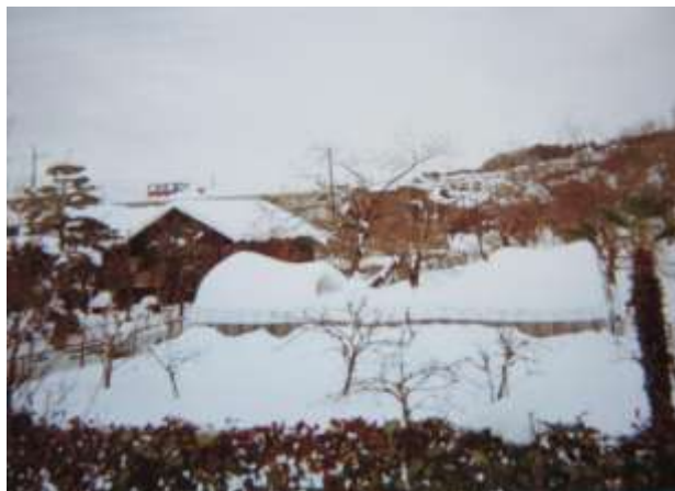
農業施設（パイプハウス）の被害状況 場 所：長沼町
