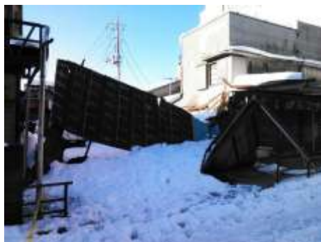
商店街のアーケード落下状況 場 所：八幡町（本郷横丁）付近
