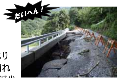
崩れた土肥新田の市道
