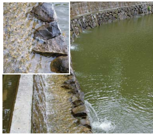
鏡池の循環ろ過装置に敷設されたEMセラミックス粗砕。既存施設にEM技術をプラスすることで、一層機能を高め、環境を安定させることができた好事例です。
