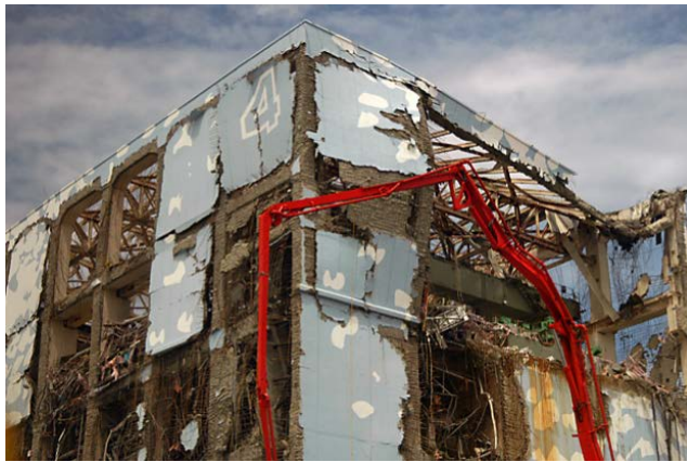
図 3.4 爆発で外壁の吹き飛んだ福島第一原子力発電所 4 号機の様子（写真は IAEA (fact finding team) による）。
