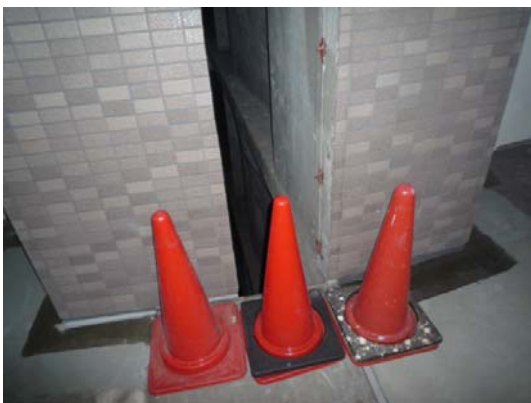
壁のエキスパンションジョイントが外れたマンション
