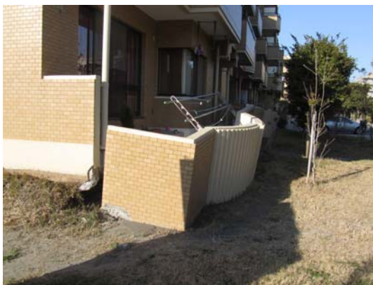
液状化により傾いた1階バルコニー手摺壁
