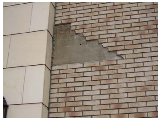
外壁のタイルが剥落したマンション
