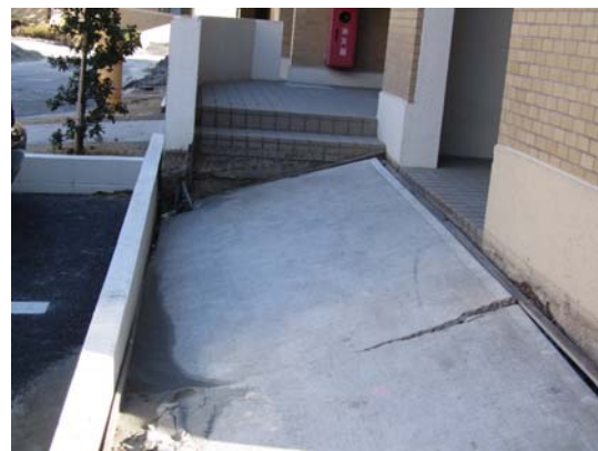
液状化により傾いた1階外部廊下床板
