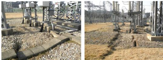
撮影：東京電力株式会社 H23.3.12
