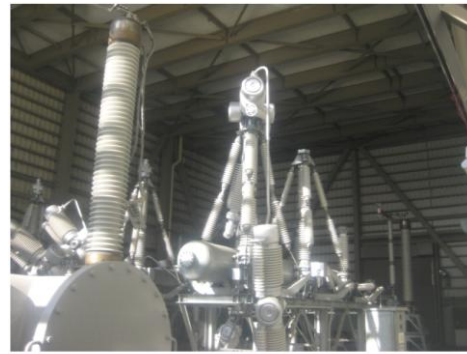
撮影：東京電力株式会社 H23.3.23
