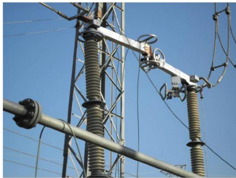
撮影：東京電力株式会社 H23.3.12
