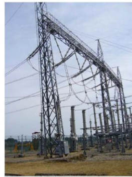
撮影：東京電力株式会社 H23.3.11
