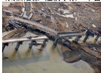
H【橋けた流失】 りくぜんこいずみ もとよし (気仙沼線 陸前小泉～本吉)
