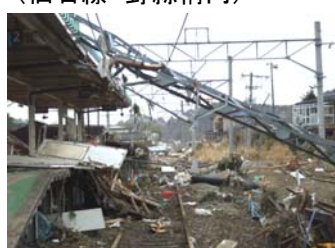
J【道床流失】 のびる (仙石線 野蒜構内)
