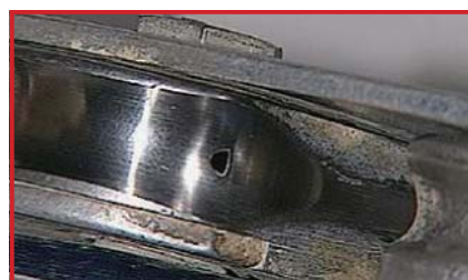
ピンに穴が開いている (要修理)
