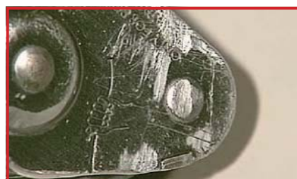
激しく損傷したリベット (注意が必要)
