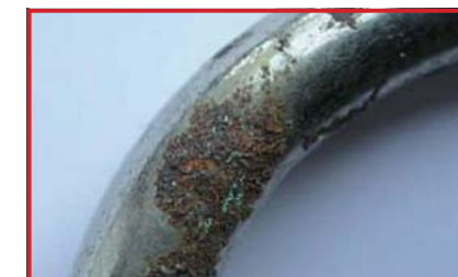
アタッチメントポイントの腐食 (注意が必要)
