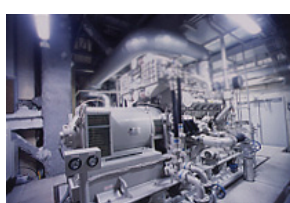
自家発電装置
