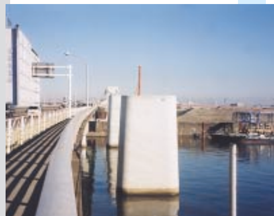
隅田川の工事…尾久橋通りの上を走る日暮里・舎人線ですが、ここでは尾久橋の横を通ります。
