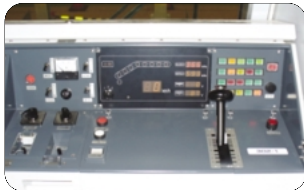
運転台(ATC信号の受信) 受信した制限速度信号は、運転台に表示されます。 (運転台は、自動運転時にはカバーが閉じています)
