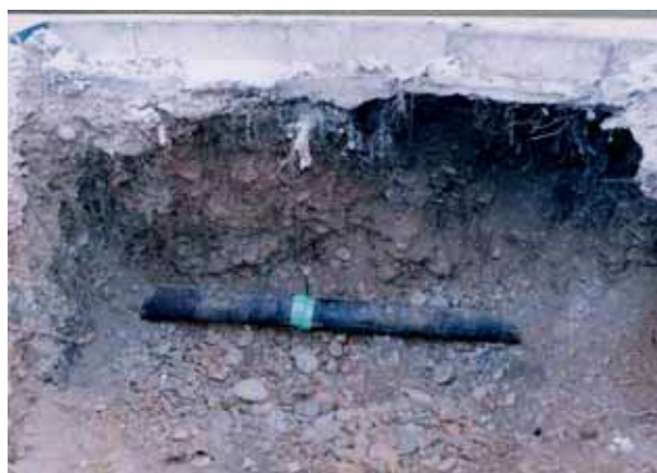
(a) 地盤クラック全体
