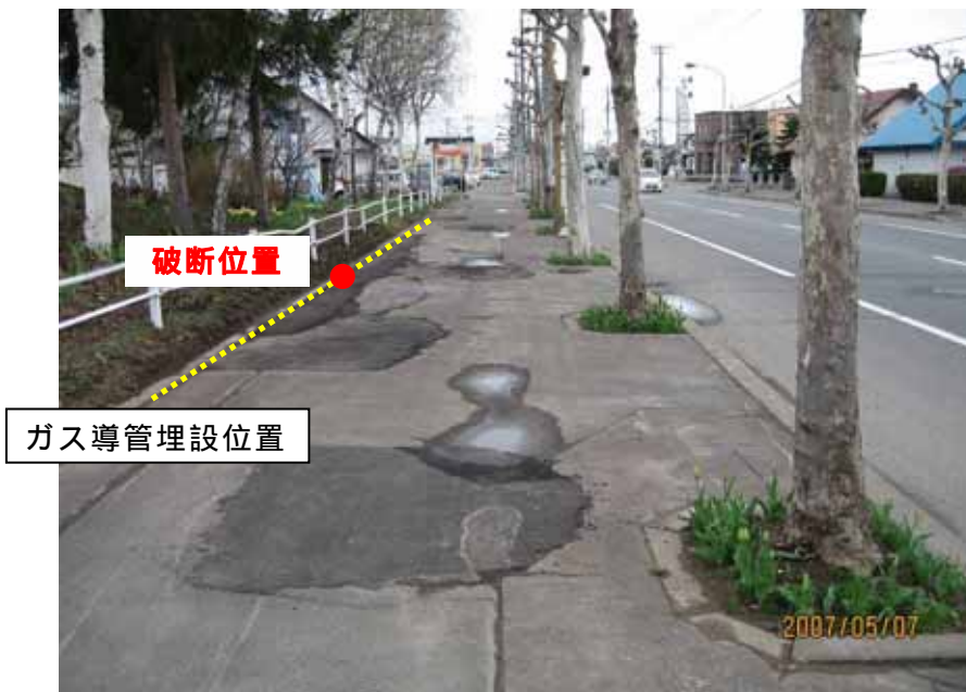
写真 4.2.3 地盤融解時における春光町管破損現場
