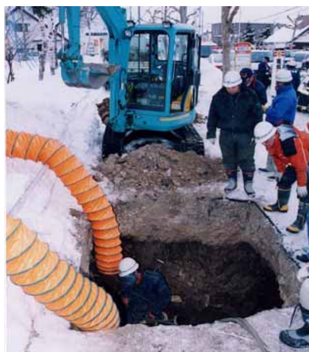
(b) 事故発生当時のガス導管破断現場 写真 4.2.1 事故発生当時の現場
