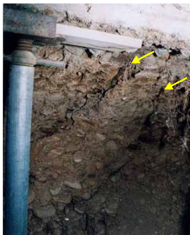
(b) 地盤クラック上部
