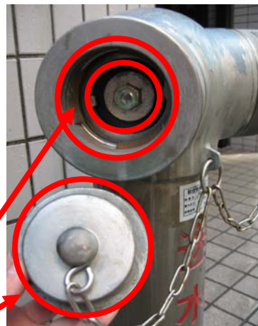
【送水口部分写真】
