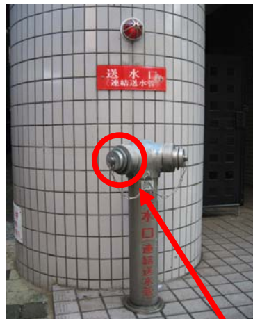
【送水口全体写真】
